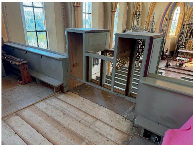
Der intakte Holzboden und die Träger waren Gott-sei-Dank intakt.
