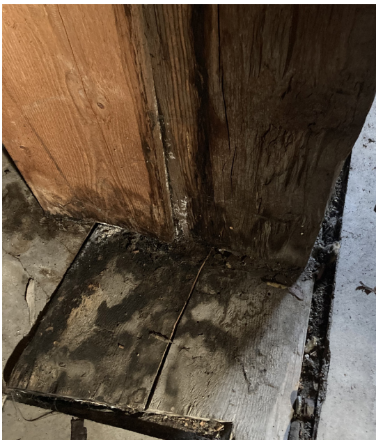
Die Wasserschäden beim Dachstuhl sind unübersehbar.
