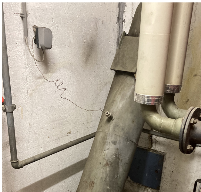
Die Ölheizung ist in die Jahre gekommen.
